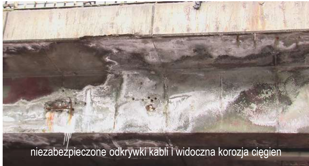
przeciekające wsporniki i wycieki wzdłuż trasy kabla sprężającego
