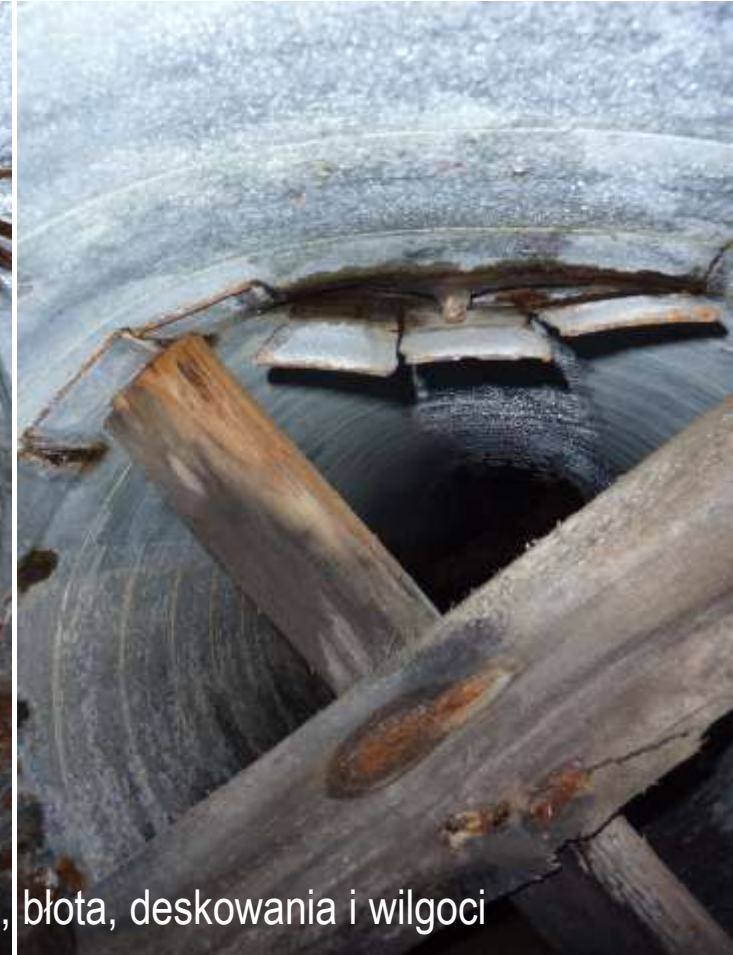
wnętrze rur spiro pełne gruzu,
